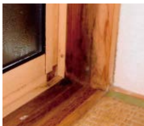
室内への雨漏り
