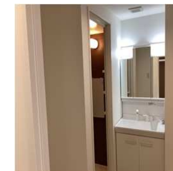
洗面設備の改良
